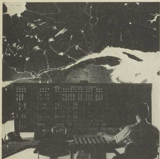
Centre de surveillance du réseau de télécommunications.
