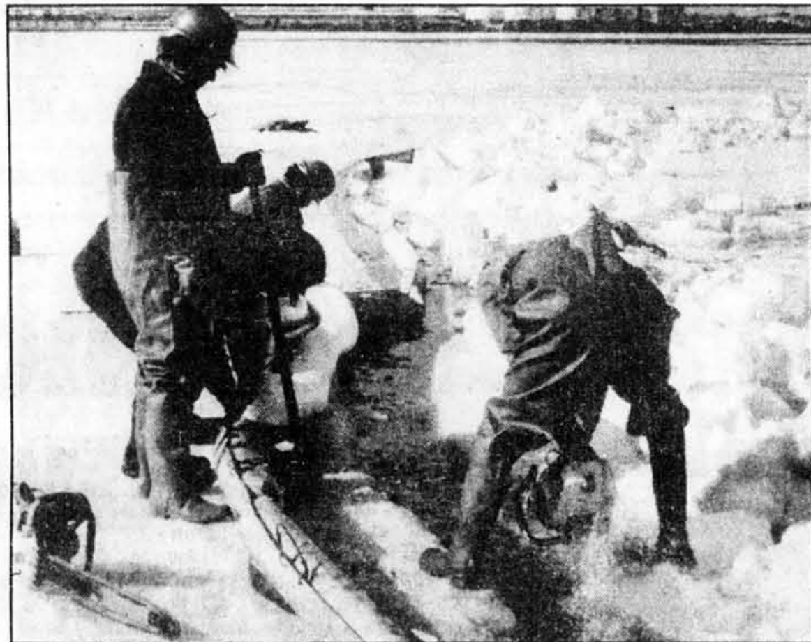
Des employés de la firme spécialisée Sanivan achèveront aujourd'hui d'installer une estacade pour contenir une fuite de carburant provenant des installations de Pratt & Whitney, à Longueuil.
