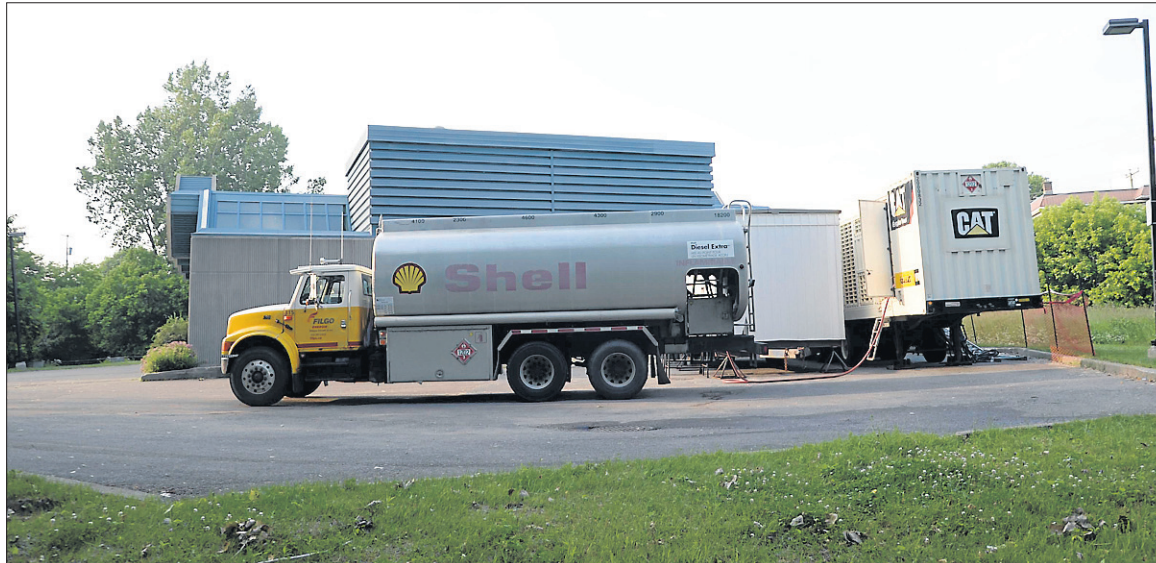
Trois-Rivières a installé une génératrice qui a permis de remettre en marche la station de pompage. — PHOTO: SYLVAIN MAYER
