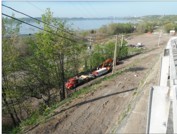
Photo 14 Tranchée excavée pour l'enfouissement de conduite pour le réseau électrique, vue vers le sud-ouest (VDQ1604-NUM1-5)
