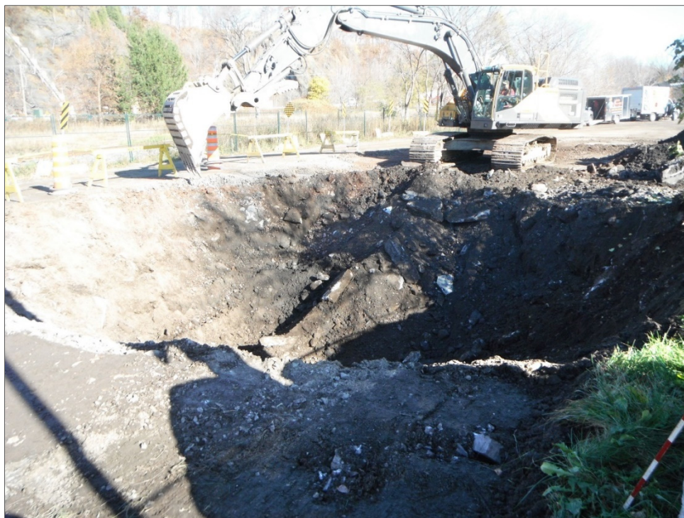
Photo 27 Localisation de la sous-opération 1E dans le stationnement entre la voie ferrée et le boulevard Champlain, vue vers le nord-est (VDQ1604-NUM1-325)
