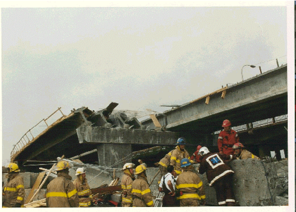
Figure 3.5 Vue des poutres 1 à 4 de la travée 1 à la pile 2 (Photo SQ-B12)
