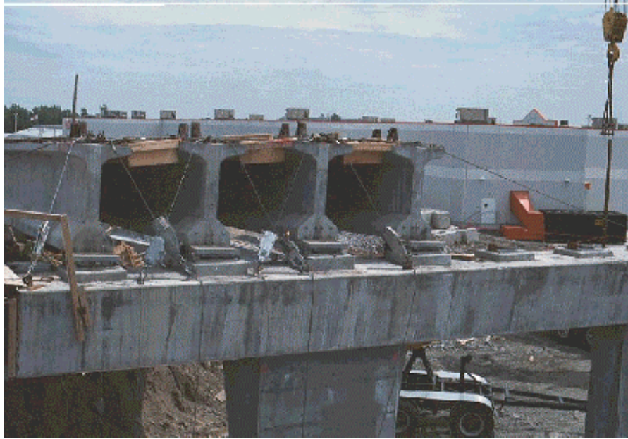
Figure 3.30 Rotation vers le sud des poutres 5 à 8 à la pile 4 (photo 280.7.02, vue vers l'est après enlèvement des poutres de la travée 3 et les poutres 1 à 4 de la travée 4)
