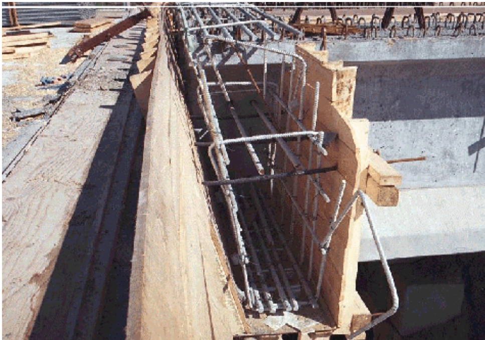
Figure 2.23 Coffrage de l'entretoise à la culée 1 (photo 330.1.04, prise après l'accident)
