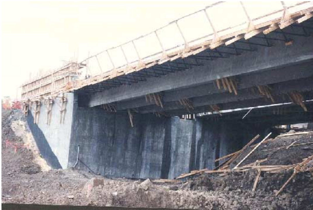
Figure 3.6 Vue des poutres 1 à 4 de la travée 1 à la culée 1 (photo pom.26)
