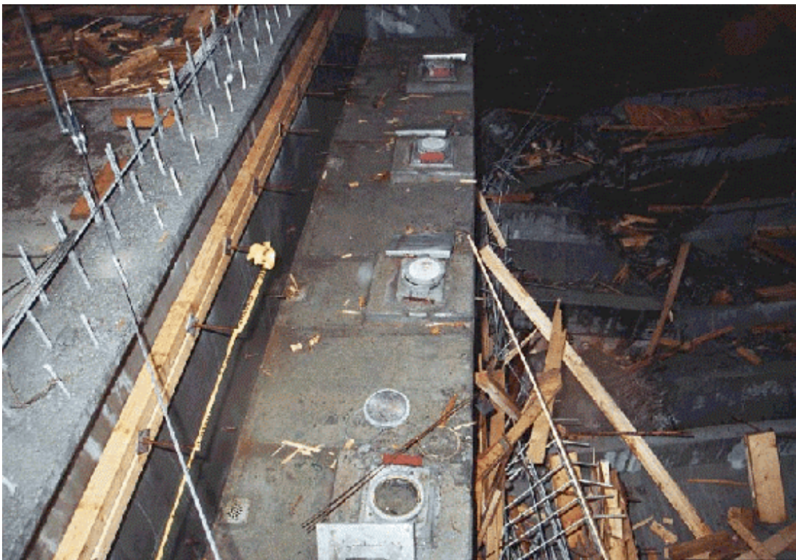
Figure 3.21 Vue de la culée 5 après nettoyage et démontage de l'appareil d'appui de la poutre 4 (photo 280.3.11)
