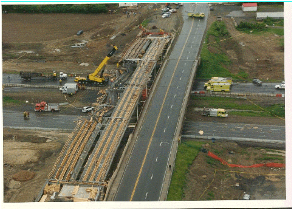
Figure 3.11 Vue vers le sud-ouest du pont après l'effondrement (photo SQ-C14)
