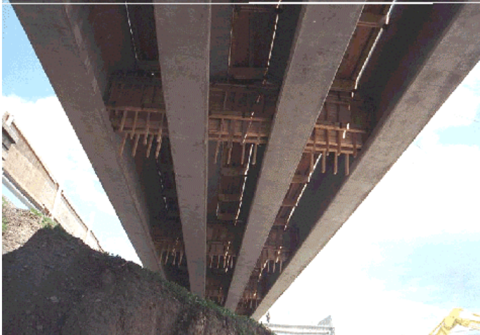
Figure 2.22 Coffrage de la dalle et des entretoises intermédiaires de la travée 4 (Photo 280.2.22, prise après l'accident)
