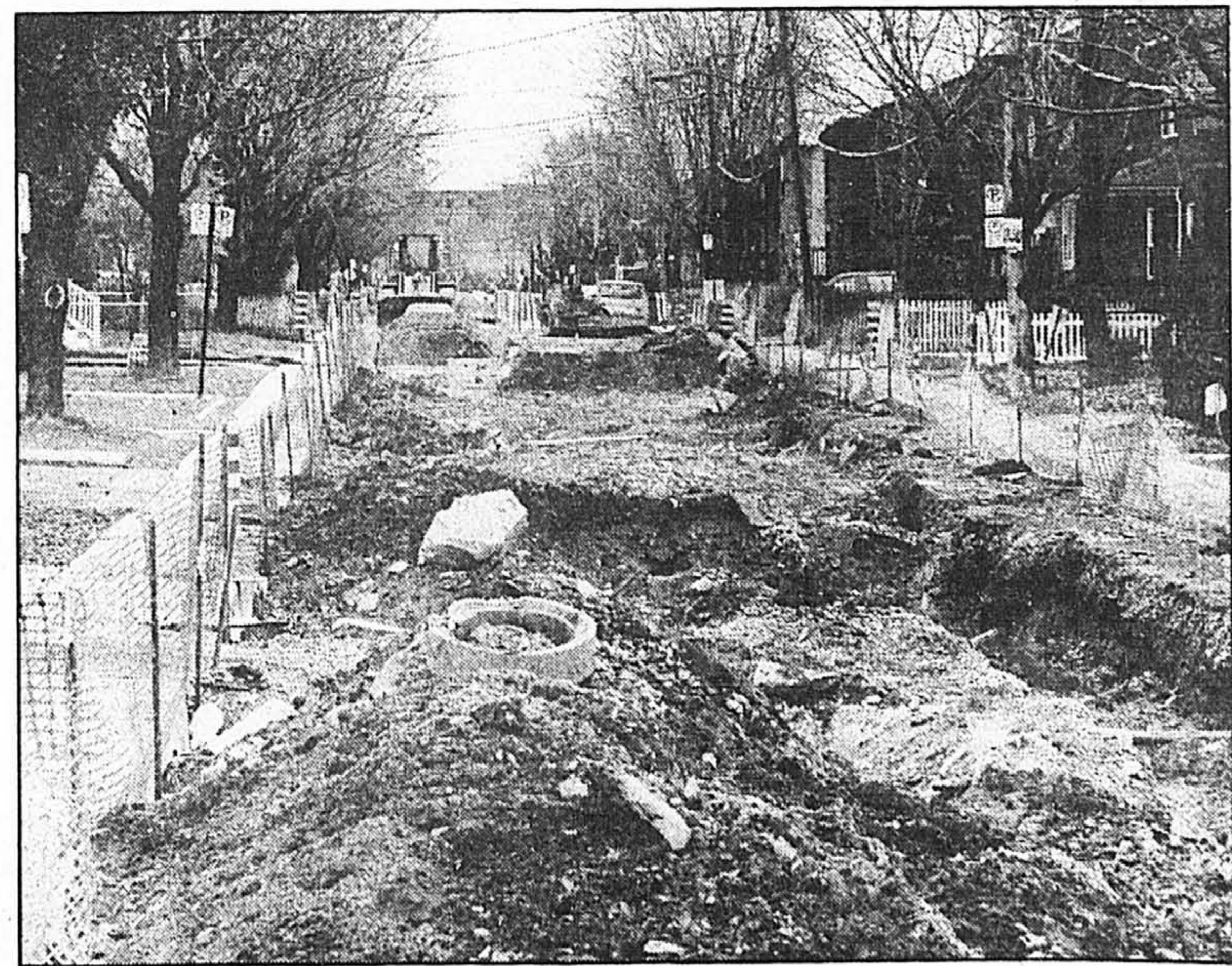
La rue Connaught à Saint-Laurent: un gigantesque trou boueux. PHOTO LUC SIMON PERRAULT, La Presse
