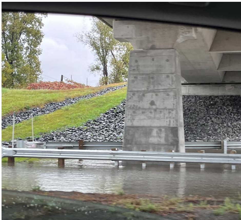
L'eau s'est accumulée sur l'autoroute 30, sous le viaduc de la montée des Promenades. (Photo : Frank Jr Rodi)
