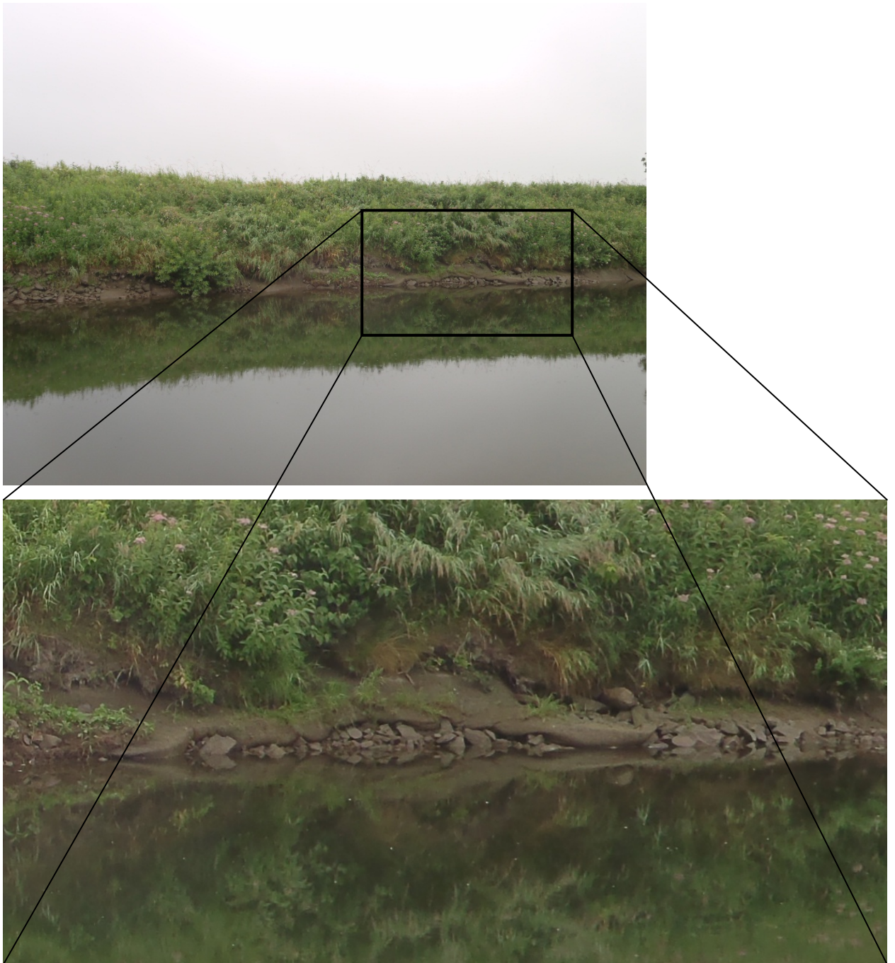
Photo 12 : Rive gauche de la Bulstrode au PK 14. Dégradation d'un ouvrage comportant une membrane géotextile. Le déchaussement de la végétation observé au-dessus de l'ouvrage laisse croire que l'érosion reprendra à court terme dans la partie supérieure de la rive.
