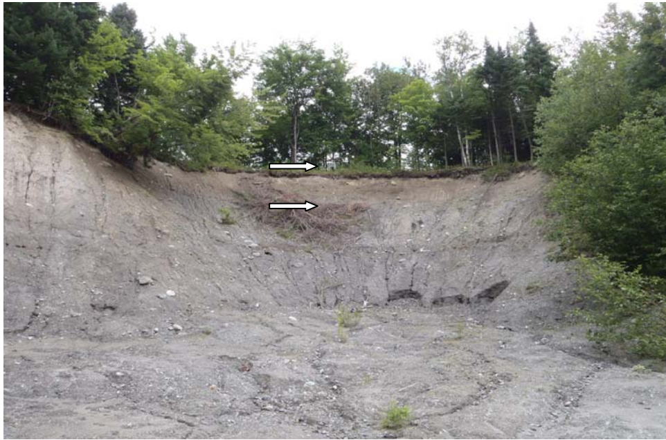
Photo 15 : Rive droite du ruisseau Gobeil au PK 5,7. La flèche du haut pointe une personne sur le rebord du talus. La flèche du bas indique le contact entre une unité sableuse de 3 m d'épaisseur et les matériaux silto-argileux occupant la base du versant. Une résurgence entre les deux couches a creusé de nombreux sillons à la surface des matériaux fins et du till, provoquant quelques petits décrochements.
