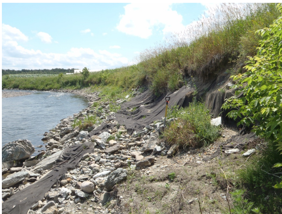
Photo 11 : Rive gauche de la Bulstrode au PK 21. Reprise de l'érosion dans un talus qui avait été « stabilisé » à l'aide d'une membrane géotextile et de cailloux et blocs.
