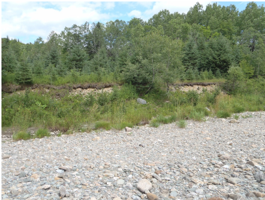
Photo 2 : Rive droite de la Bulstrode au PK 46,4. Légère érosion dans la portion supérieure du talus composé de sable et gravier. Un pavage de cailloux en contrebas du talus riverain protège la rive contre l'érosion en dehors des périodes de hautes eaux.
