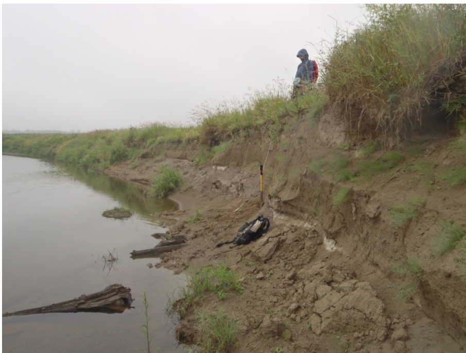
Photo 9 : Rive gauche de la Bulstrode au PK 13,8. Talus dénudé de 2,4 m de hauteur composé de silt et sable fin.
