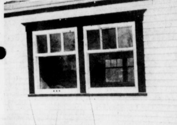
La plupart des carreaux des fenêtres ont été brisés.
