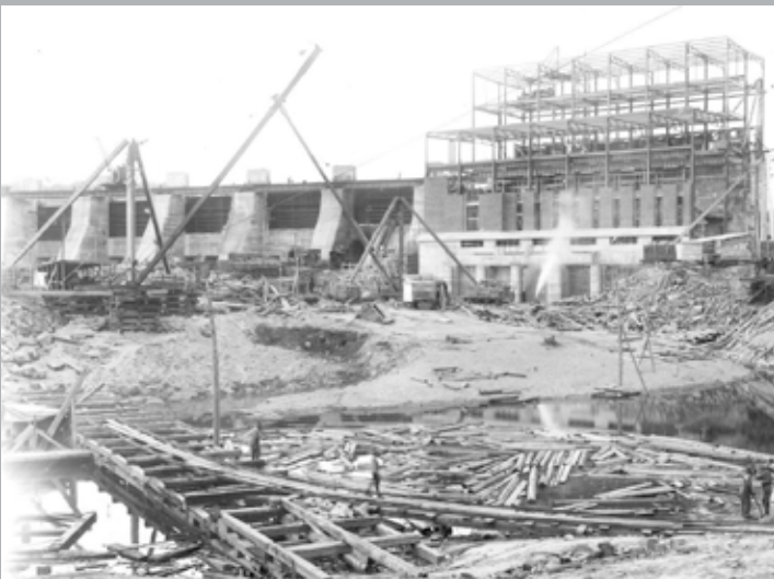
Cette photo nous permet de voir que les eaux avaient été déviées pour permettre la construction de la centrale hydroélectrique.
