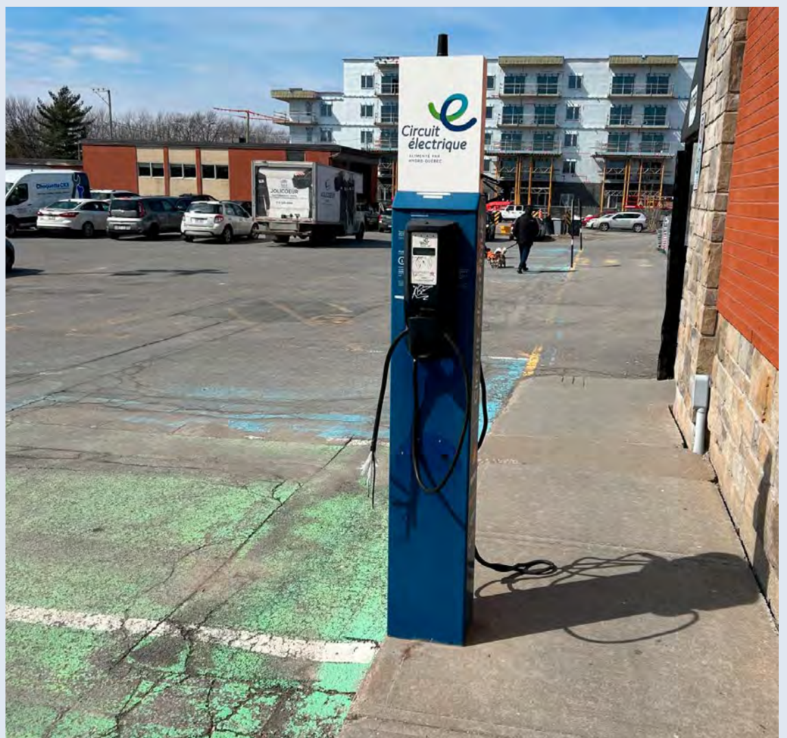
Quelques mois après son installation, la borne de recharge électrique de la place Chambly a subi des dommages. Espérons que ce geste maladroit restera marginal même si les bornes de recharge sont nombreuses à Chambly. (Photo : Journal de Chambly)
