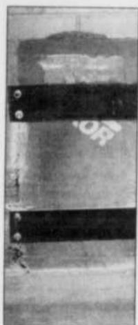
Pour maintenir l'alignement, des plaques d'acier sur les fissures.
