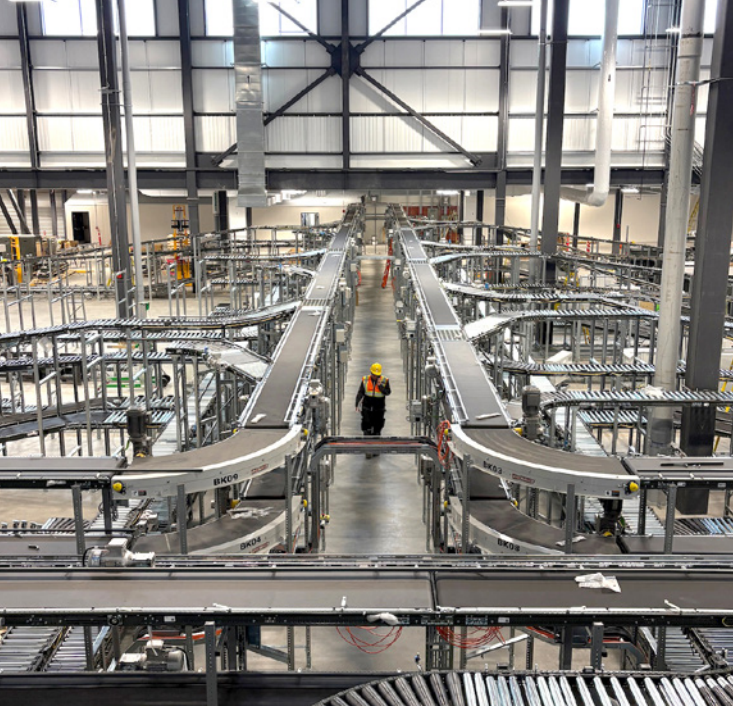
Centre de distribution automatisé, novembre 2025
