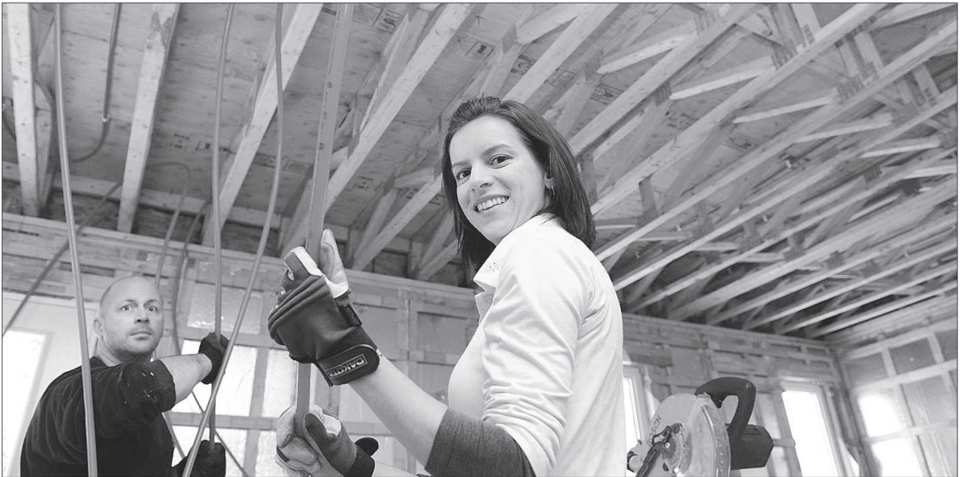
Le chauffage radiant à l'eau chaude, ça représente des mètres et des mètres de tuyaux qui seront installés dans les entreplanchers. Ce type de chauffage coûte plus cher, mais il est, selon les experts, plus confortable, plus économe d'énergie et plus écologique. — PHOTO LE SOLEIL, STEVE DESCHÈNES
