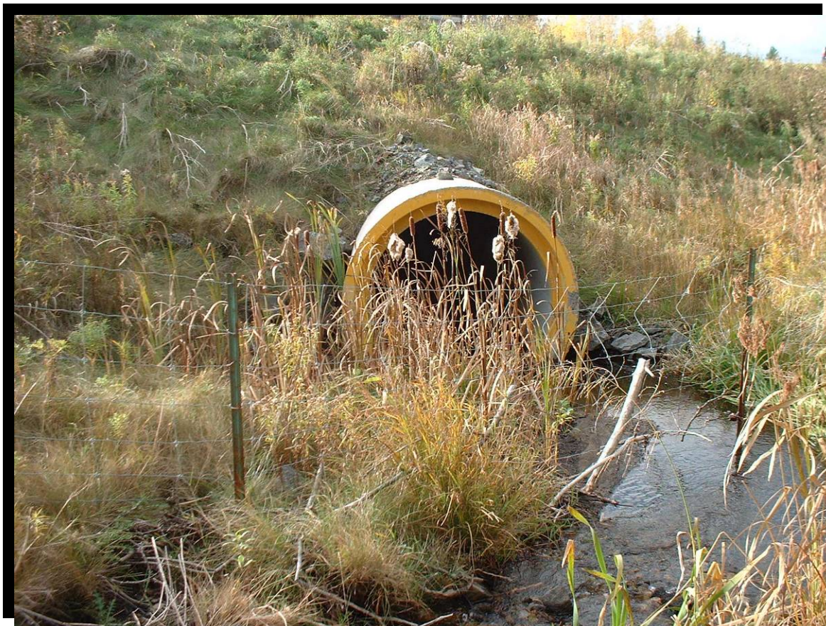
FIGURE 109 Ponceau circulaire en béton armé (TBA). Malfaçon en raison d'une mauvaise stabilisation des fossés adjacents qui a causé un apport de sédiments au droit du ponceau. La croissance de la végétation sur cet îlot annonce un éventuel problème de drainage qui nécessitera des travaux d'entretien hâtifs. (0000.1121)
