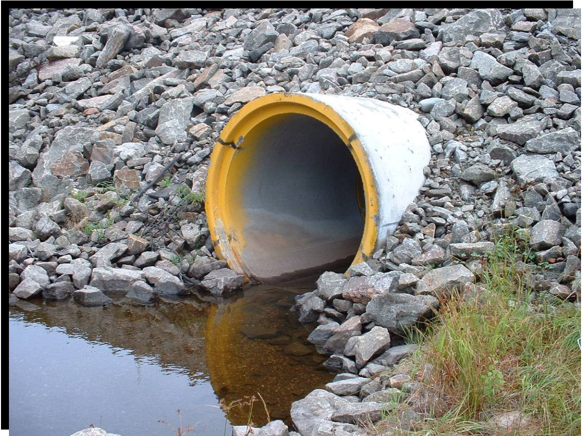
FIGURE 107 Ponceau circulaire en béton armé (TBA). Malfaçon en raison d'un manque d'enfouissement du ponceau. (0000.1122)
