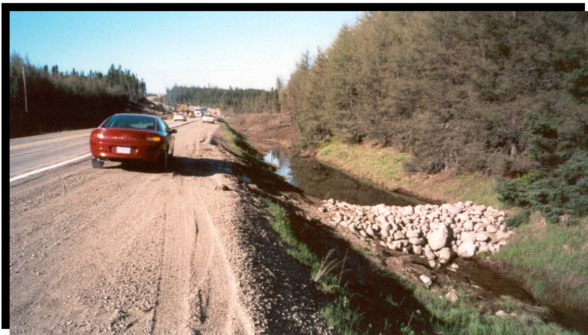
FIGURE 124 Berme filtrante et trappe à sédiments dans un fossé. Route 175 dans la réserve faunique des Laurentides, du kilomètre 144 au kilomètre 149, secteur de la rivière Pikauba. (2000.1036)
