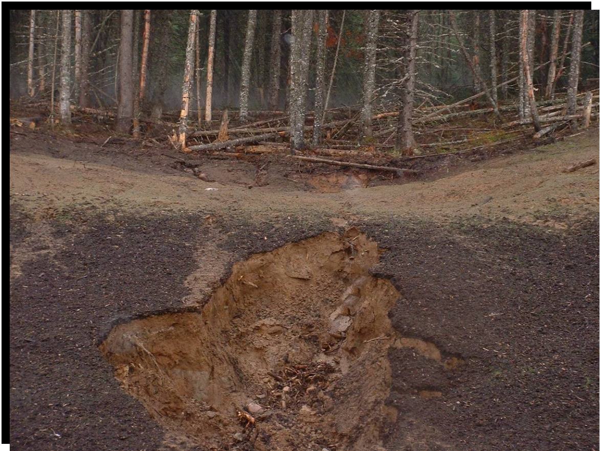
FIGURE 53 Ravinement au pied d'un vallonement de terrain en haut de talus. (0000.1062) Défectuosité à corriger.
