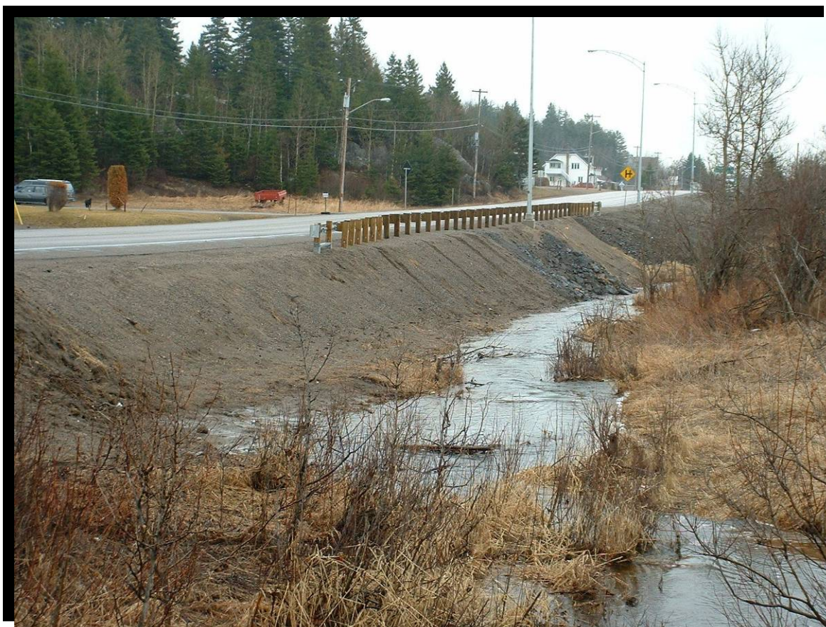
FIGURE 63 Remblai pour l'élargissement de l'accotement et pose de glissières de sécurité. Défectuosité à corriger en raison d'un manque de stabilisation du talus de la route en bande riveraine d'un cours d'eau. (0000.1069)
