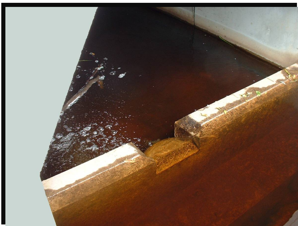
FIGURE 12 Route 170 à Saint-Félix-d'Otis, émissaire du lac Goth. (2001.1012) Vue d'un déversoir . (Voir commentaires de la figure précédente).
