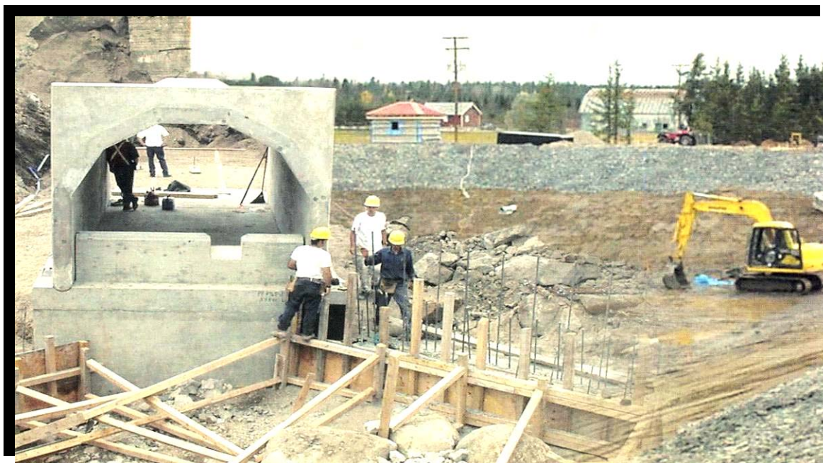
FIGURE 11 Route 170 à Saint-Félix-d'Otis, émissaire du lac Goth. (2001.1011) Ponceau voûté de 3 m de largeur sur 2,5 m de hauteur et de 79,8 m de longueur sous un remblai de 12 m, conçu avec une échelle à poissons , composée de 10 déversoirs distants d'environ 8,8 m pour permettre la montaison de l'omble de fontaine dans un ouvrage possédant une pente de 2,9 % et des vitesses d'eau projetée sans déflecteur de 9 m/s. (Composante ichtyofaune du milieu naturel biologique)
