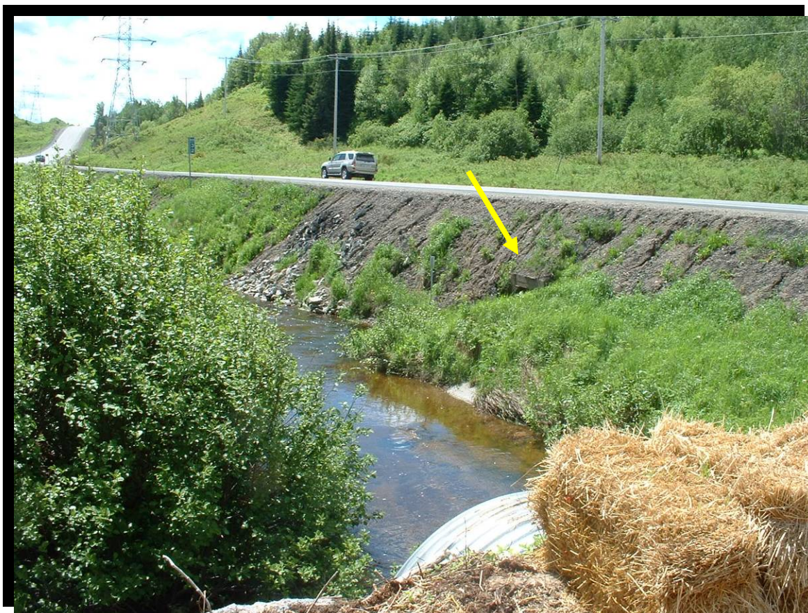
FIGURE 101 Ponceau de drainage à rallonger au droit d'un cours d'eau qui longe la route. Route 169 dans la réserve faunique des Laurentides, au kilomètre 32. (2004.1116)
