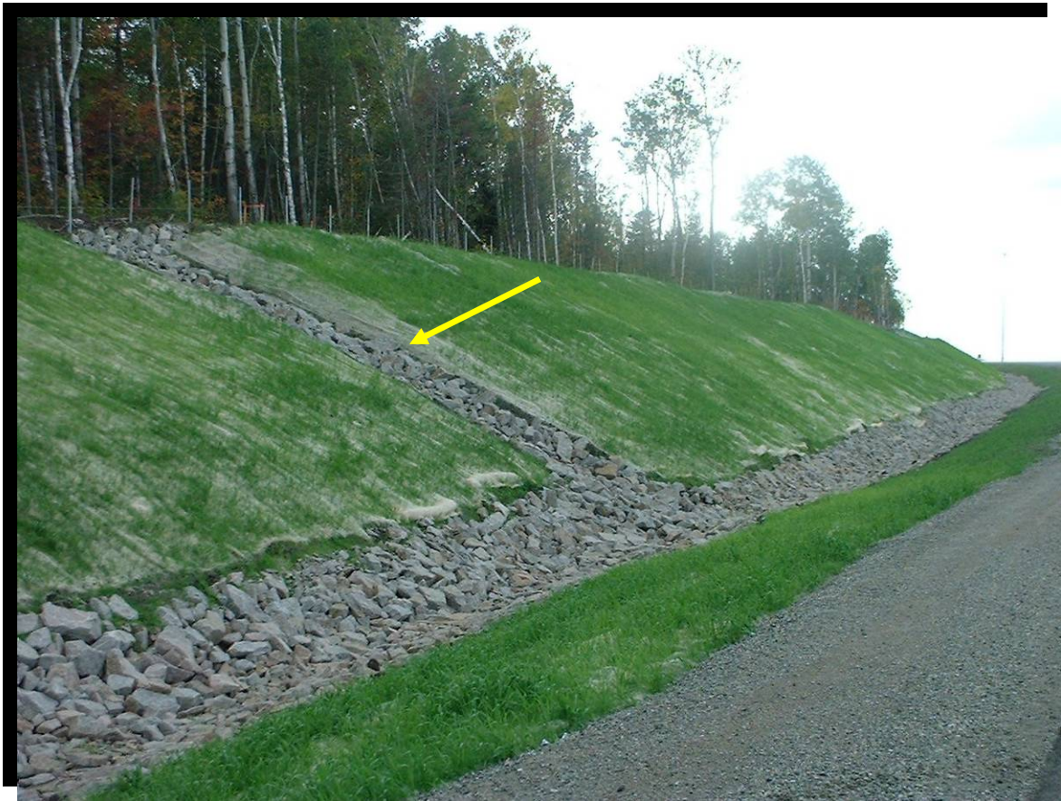
FIGURE 52 Stabilisation par empierrement d'une résurgence dans un talus de déblai. Autoroute 70 à Jonquière, secteur du ruisseau Jean-Dechêne. (2001.1041)
