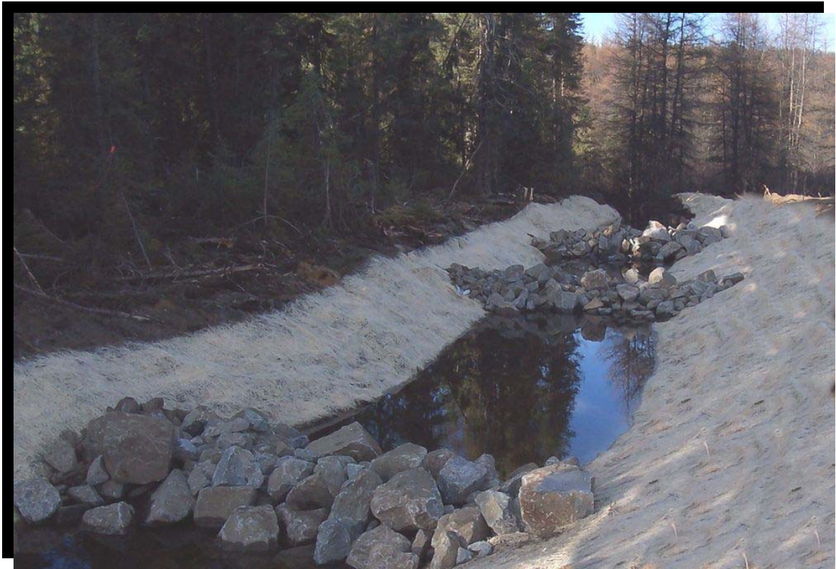
FIGURE 128 Bermes filtrantes et trappes à sédiments permanentes dans un fossé de décharge. Route 175 dans la réserve faunique des Laurentides, au kilomètre 149, secteur de la rivière Pikauba. (2004.1083)
