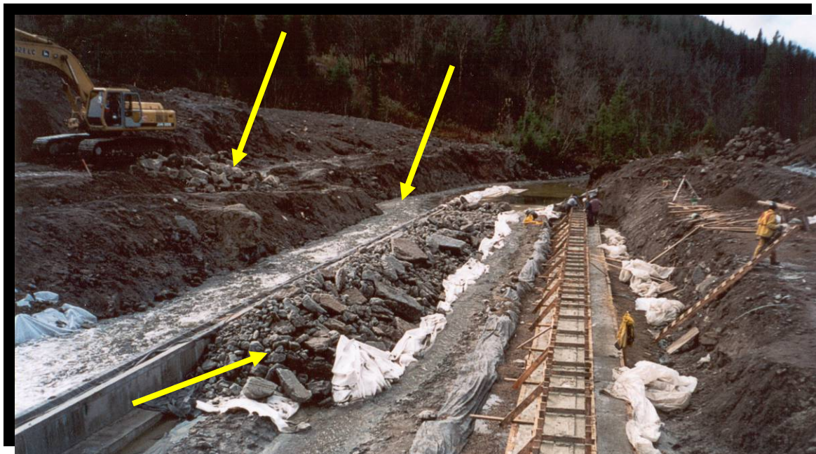
FIGURE 74 Canal de dérivation temporaire pour la construction des semelles d'un ponceau de type portique. Récupération du substrat du lit du cours d'eau. Malfaçon en raison d'un manque de mesures de stabilisation du canal et d'absence de mesures de contrôle de l'érosion sur les berges. (0000.1128)
