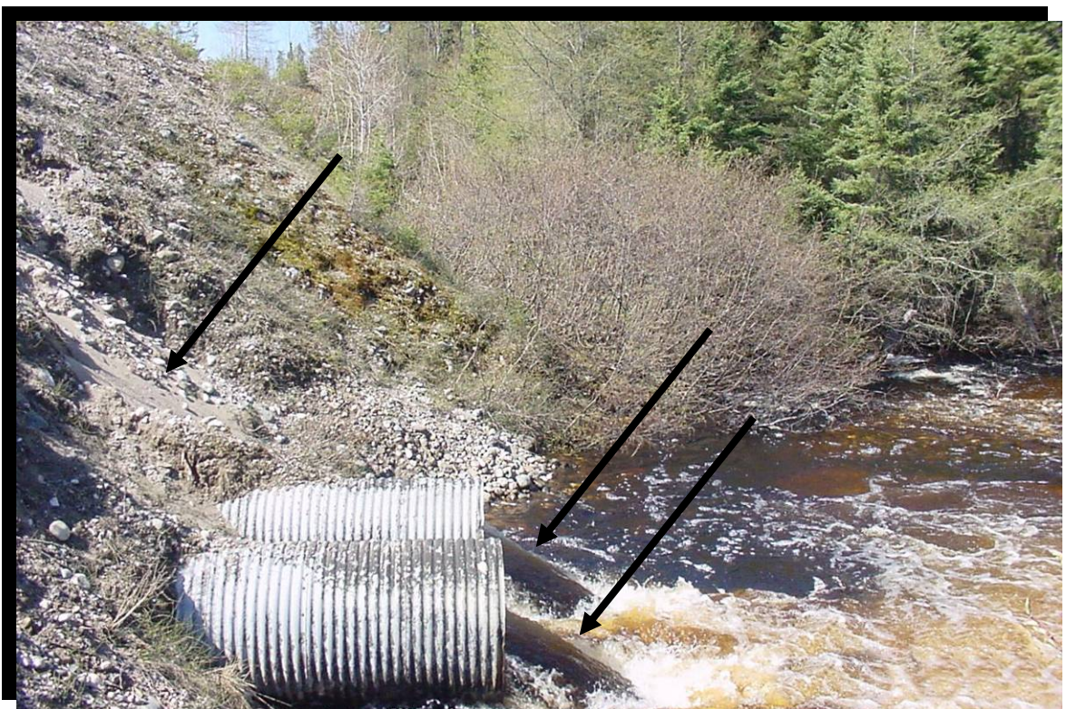
FIGURE 108 Ponceaux circulaires en acier (TTOG) installés en parallèle. Malfaçon en raison d'absence de stabilisation du talus de la route et des extrémités des ponceaux ainsi qu'en raison d'une installation des ponceaux rendant le cours d'eau infranchissable pour le poisson. (0000.1131)
