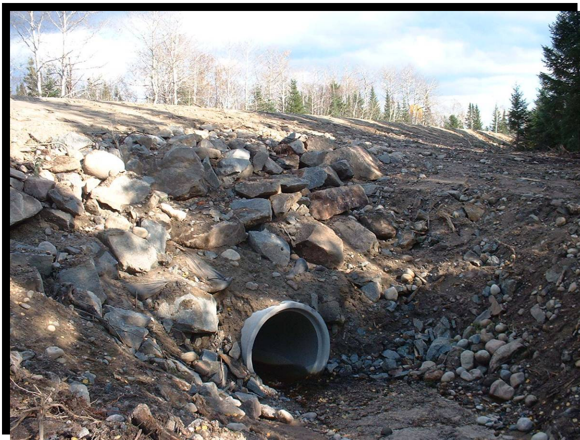
FIGURE 105 Ponceau circulaire en béton armé (TBA). Malfaçon en raison d'une mauvaise stabilisation des sols et d'un manque d'enfouissement du ponceau. (0000.1119)
