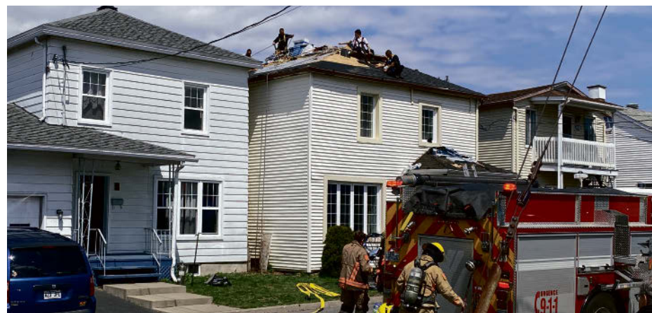
Les couvreurs qui réparaient le toit d'une maison sur la rue Chevalier ont averti le propriétaire de la maison voisine d'un début d'incendie sur le mur extérieur de sa résidence.
