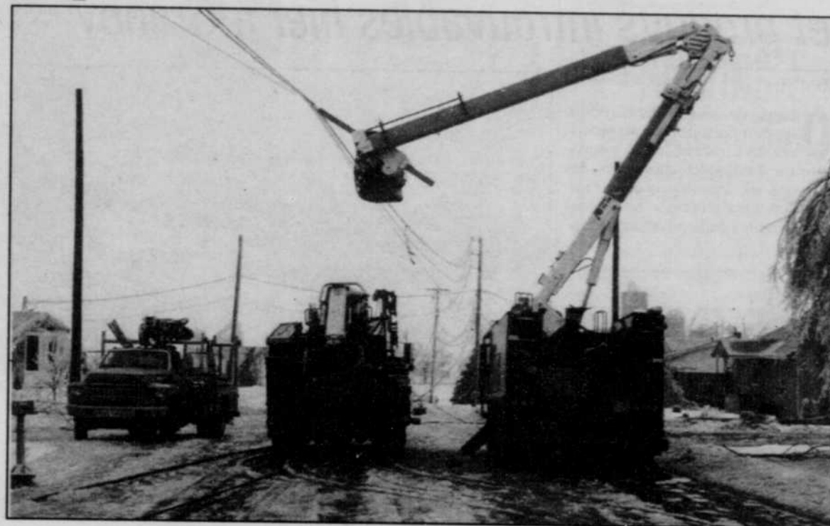
Hydro-Québec, incapable hier soir de quantifier le nombre de clients privés de courant, ne pouvait non plus se faire rassurante. Le temps maussade pourrait encore faire empirer la situation.
