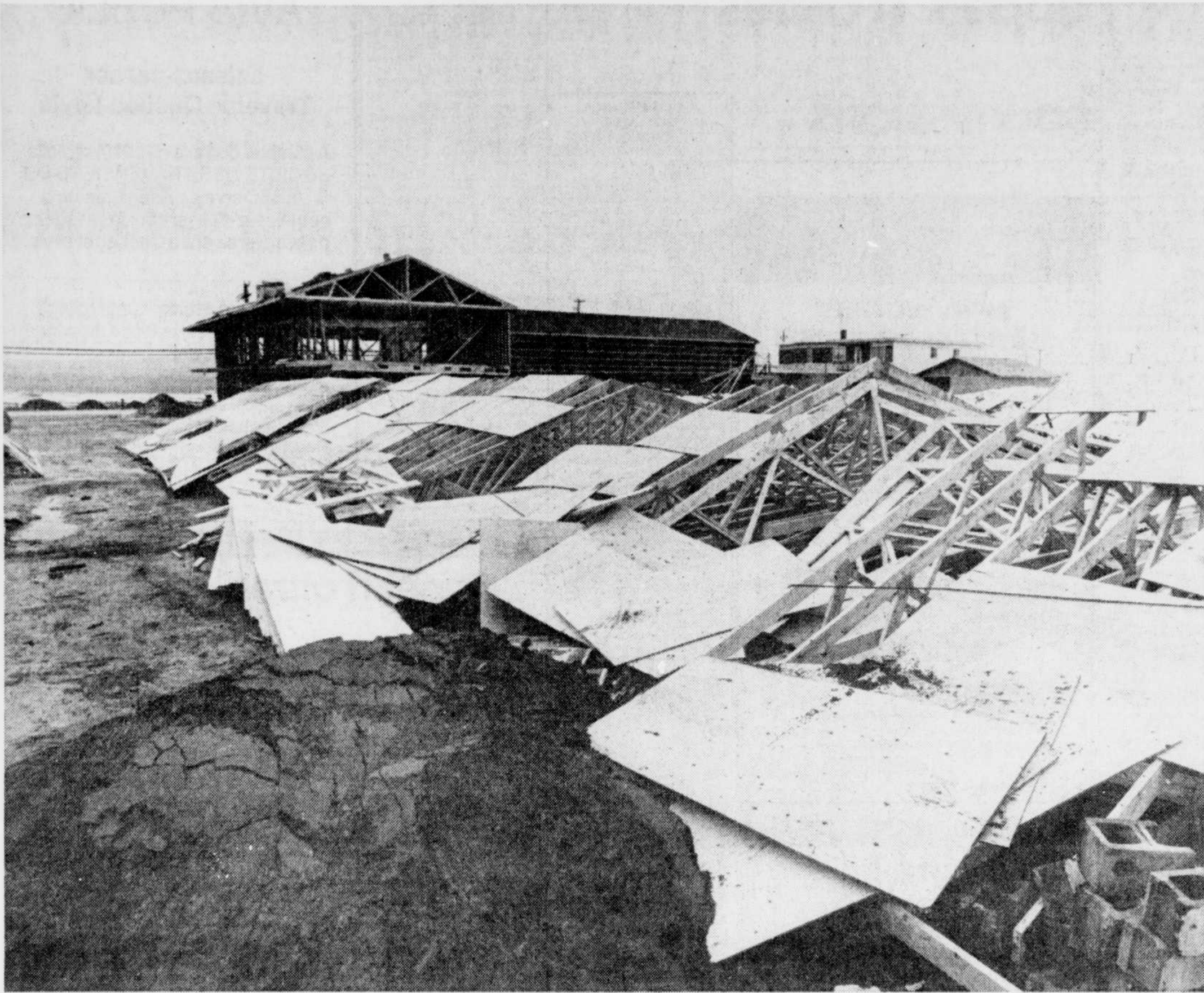
Frappé par de mauvais coups du sort à quelques reprises déjà dans le passé, "Le Balmoral" en reconstruction a été en grande partie soufflé par le vent hier, plus de la moitié de ses unités de logement s'écroulant comme un château de cartes.
