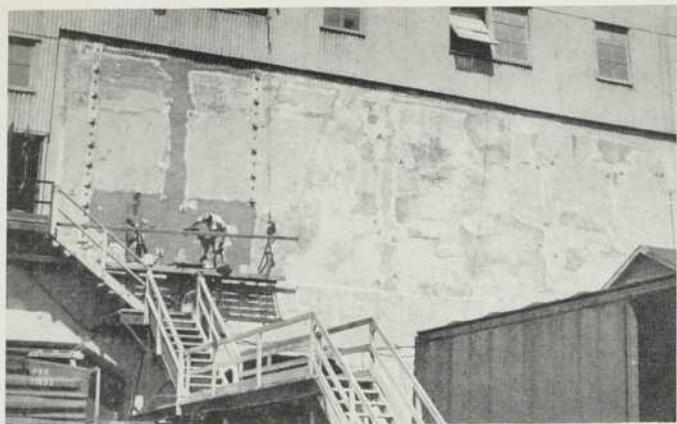
Fig. 2 — L'édifice de l' International Salt Co. , à Détroit, dont les murs de béton étaient dangereusement crevassés, est ici restauré à l'aide de ce nouveau composé polyplastique.
