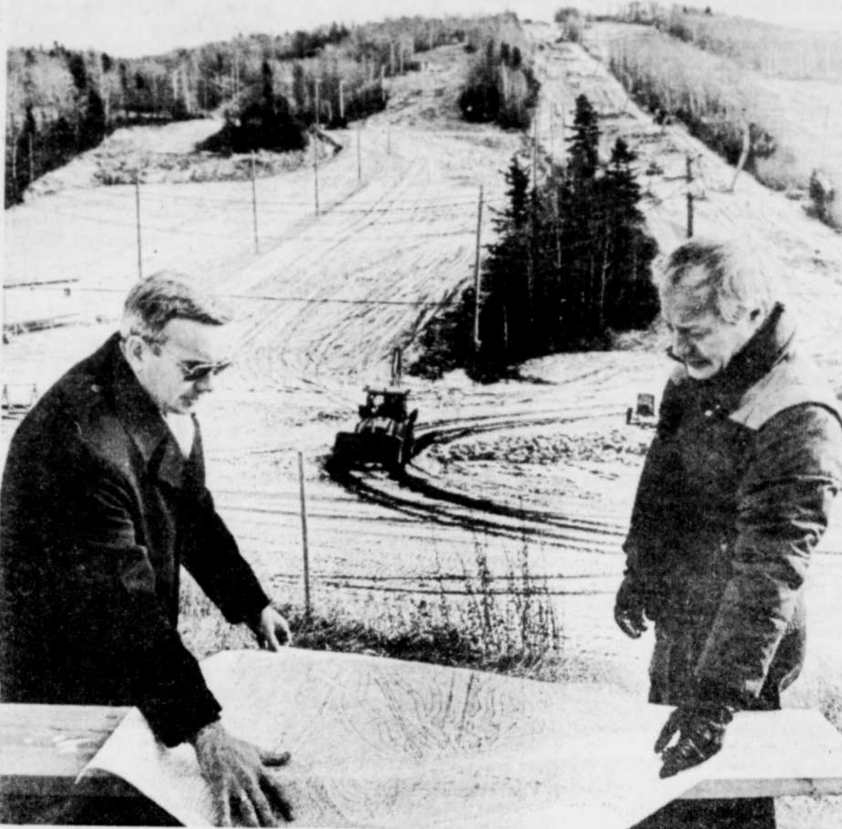
Au Relais du lac Beauport, l'absence de canons à neige n'enlevait rien à la frénésie des travaux préparatoires à l'ouverture de la saison. À droite, le directeur M. Jean-Claude Tremblay, et son adjoint, M. Claude Beaulieu.
