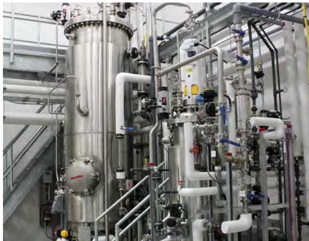
Hydrolyseurs de 150 et de 2000 litres
