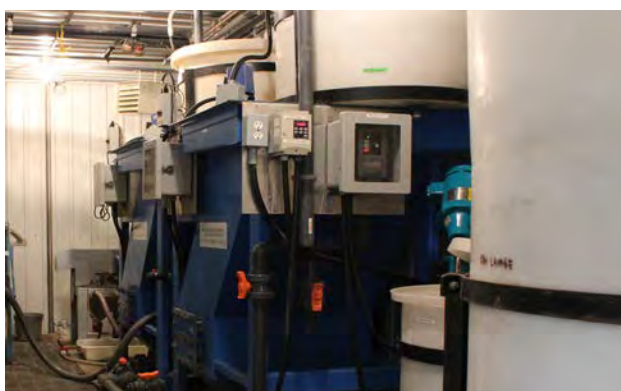
Décanteurs lamellaires avec instrumentation
