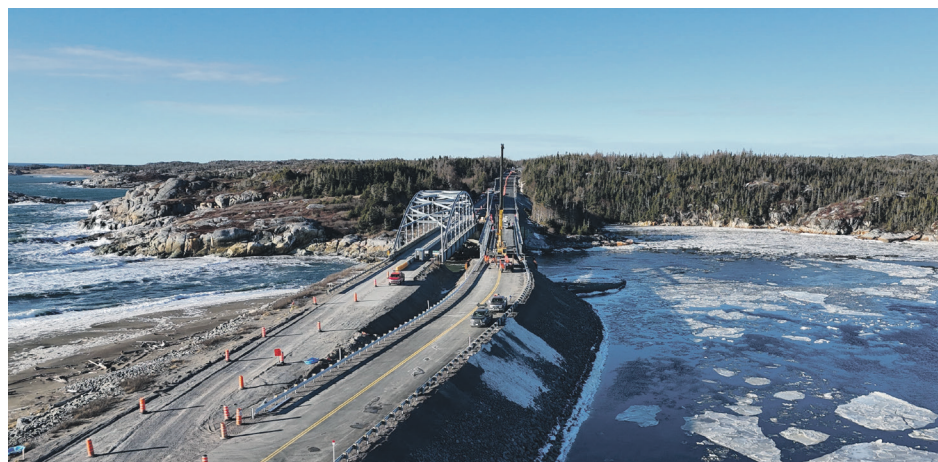
Le pont modulaire, de type Delta, a une longueur de près de 95 mètres et une largeur carrossable de 7,35 mètres. Photo courtoisie
