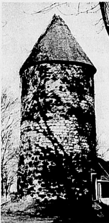
C'est un peu l'aspect que prendra notre vieux coulin si on s'empresse de le restaurer au lieu de le vouer au démantèlement. Sis auprès des élévateurs à grain, il regarde tristement de ses fenêtres béantes le triste entourage qui est sien. Il n'a pas eu de veine comme celui de Pointe-aux-Trembles qu'illustre notre photo. Admirablement conservé, ce monument rustique représente bien l'architecture typique des moulins à vent construits aux XVIIe et XVIIIe siècles au Canada français! En vieillissant, la tour ronde a perdu ses ailes, mais elle continue à résister victorieusement aux intempéries, mettant ainsi en relief l'excellence des techniques utilisées par ses constructeurs.—(Ministère des Affaires culturelles du Québec).
