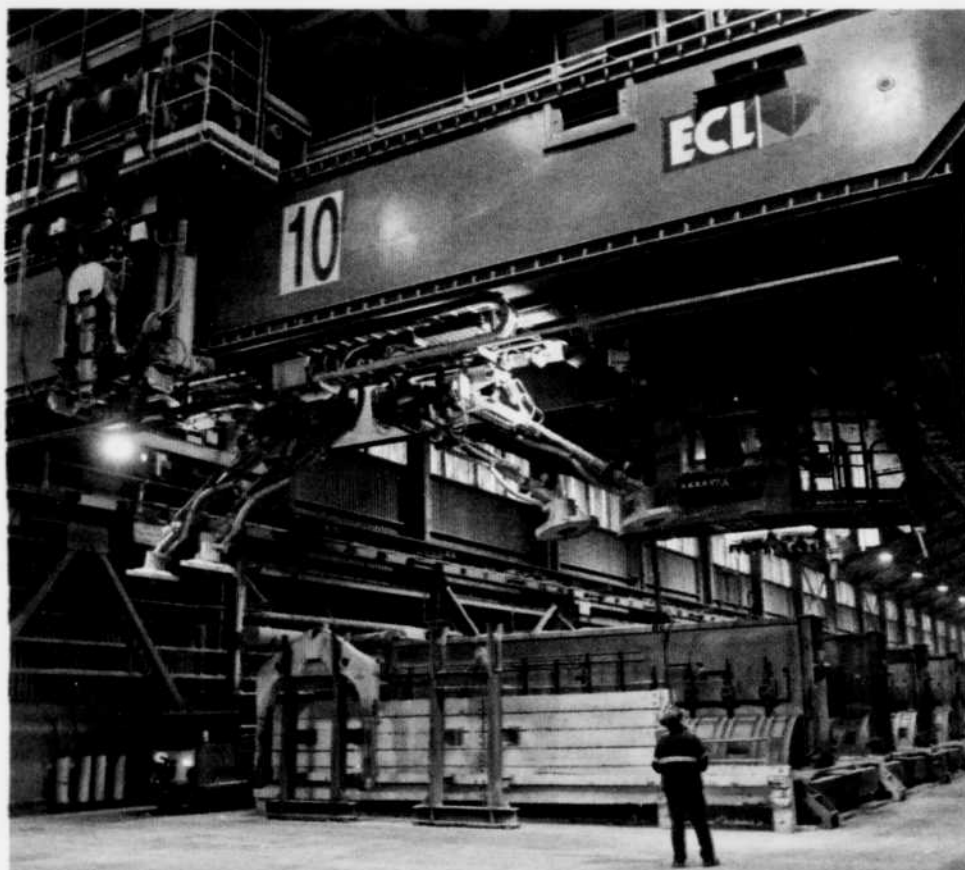
Le 22 septembre 2009, un incendie a complètement ravagé la salle électrique du pont roulant numéro 10 de l'usine Laterrière. Une équipe a rapidement été formée et il a été remis en fonction en seulement trois mois.
