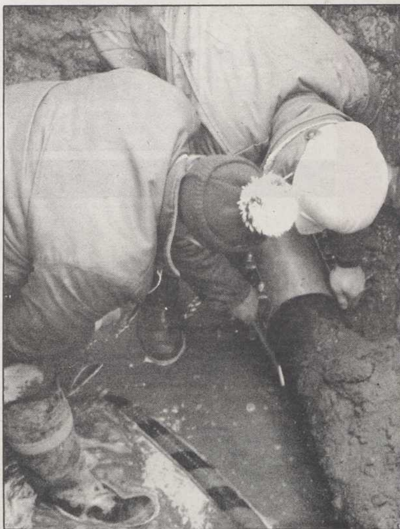
Une gaine d'étanchéité posée sur la conduite défectueuse a réglé le problème. Mais il aura fallu creuser jusqu'à 7 mètres de profondeur sur une distance de 15 mètres avant de trouver la défectuosité qui a privé d'eau 130 foyers de Saint-Paul, hier.
