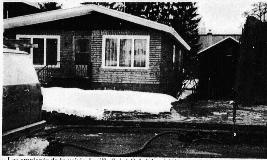
Les employés de la voirie de ville Saint-Gabriel ont été tenu très occupés la semaine dernière, alors qu'on a eu à réparer trois bris des tuyaux d'aqueduc. Celui de la rue Monday, qu'on voit ici, a été le plus important, l'eau inondant la cave d'une maison et se répandant dans les pelouses.
