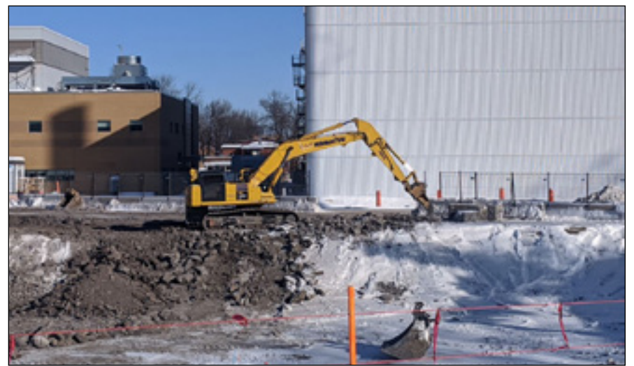
Malgré la neige, l'excavation préalable à la construction du futur bâtiment des soins critiques a débuté. La construction de cet important bâtiment se terminera en décembre 2023.
