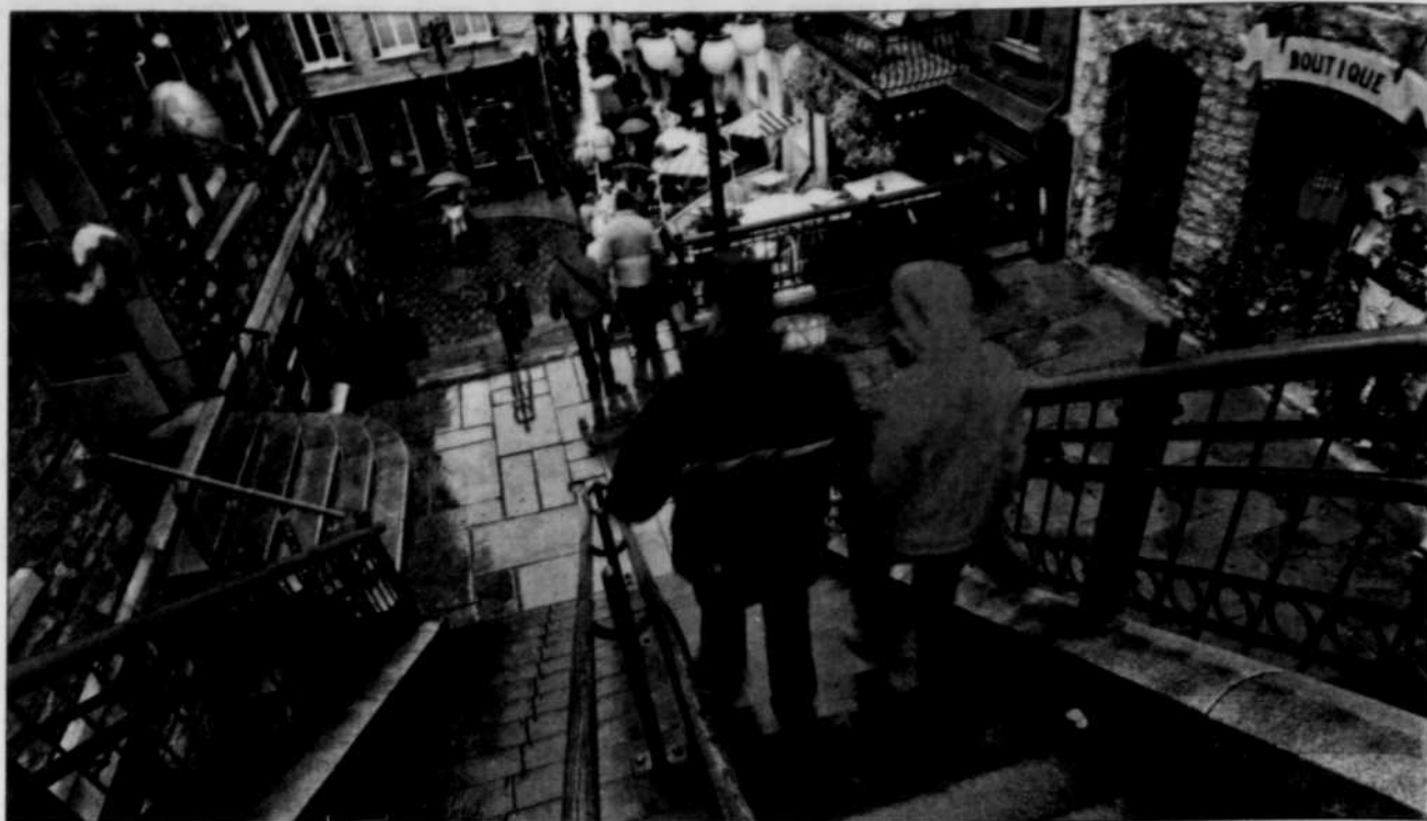
La construction de l'escalier Casse-Cou remonte à 1968 et des signes évidents de vieillesse sont apparus ces dernières années.
