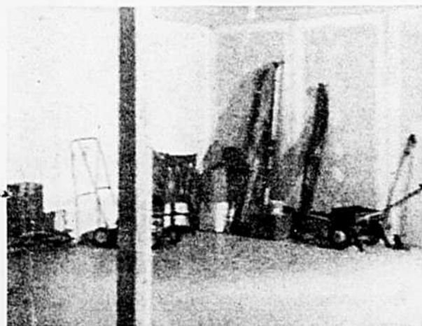
Les colonnes du support qu'on trouve dans les sous-sol causent souvent des problèmes esthétiques.
