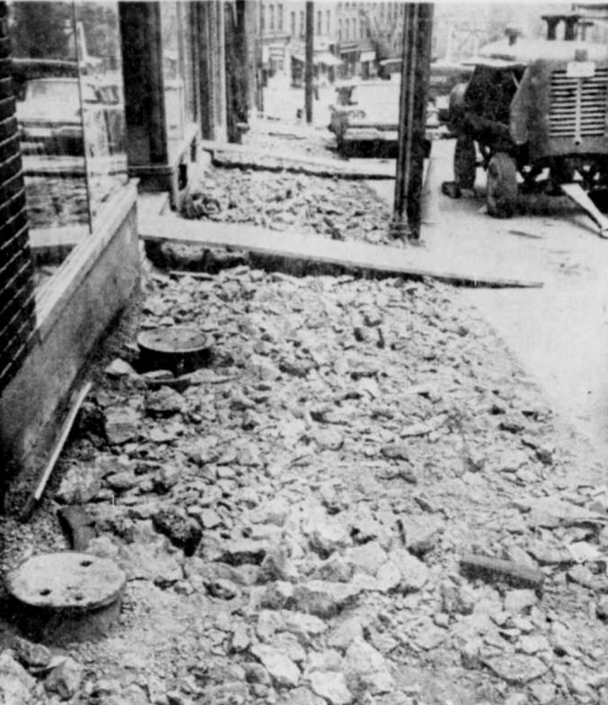
Rénovation. — Aux premiers abords, en regardant cette photo, on serait porté à croire qu'il s'agit du résultat d'un bombardement. Toutefois, il ne s'agit plutôt de travaux de réfection de trottoirs qu'on effectue à quelques endroits dans la Cité. Ici, ce sont les travaux effectués rue Frontenac, près de Dufferin. (Photo La Tribune)
