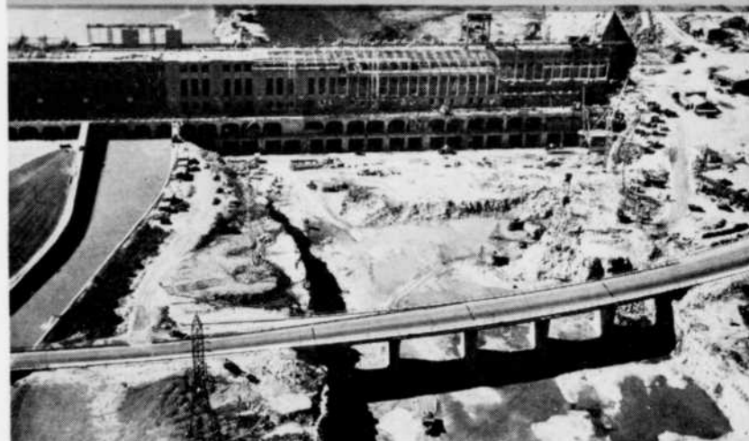
BEAUHARNOIS. Stratégiquement située à la sortie du canal de 15 milles reliant les lacs Saint-François et Saint-Louis, cette centrale comprend 36 groupes principaux. L'excavation de ce canal a exigé l'enlèvement de 15% de déblais de plus que le canal de Panama et deux fois plus que la Voie Maritime du Saint-Laurent.
