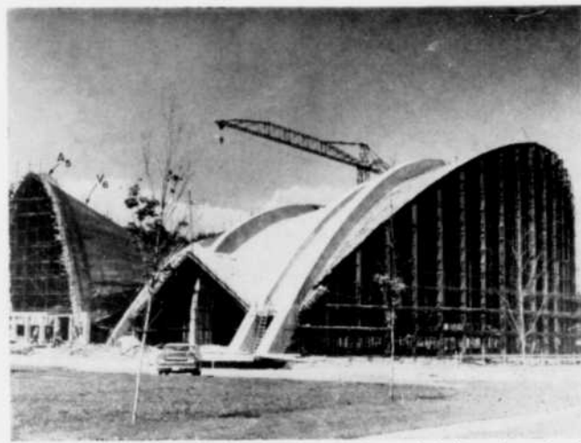
Fig. 7 — Vue générale de la grande nef bétonnée et du ferrailage du transept.
