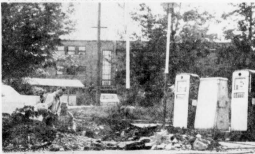
DES PROSPECTEURS? — Ces travailleurs ne sont pas à la recherche d'une nappe pétrolière, comme on serait enclin à le croire à la suite de la grève des détaillants d'essence. Ils travaillent à l'installation d'un réservoir. (Photo La Tribune, par Studio Breton)
