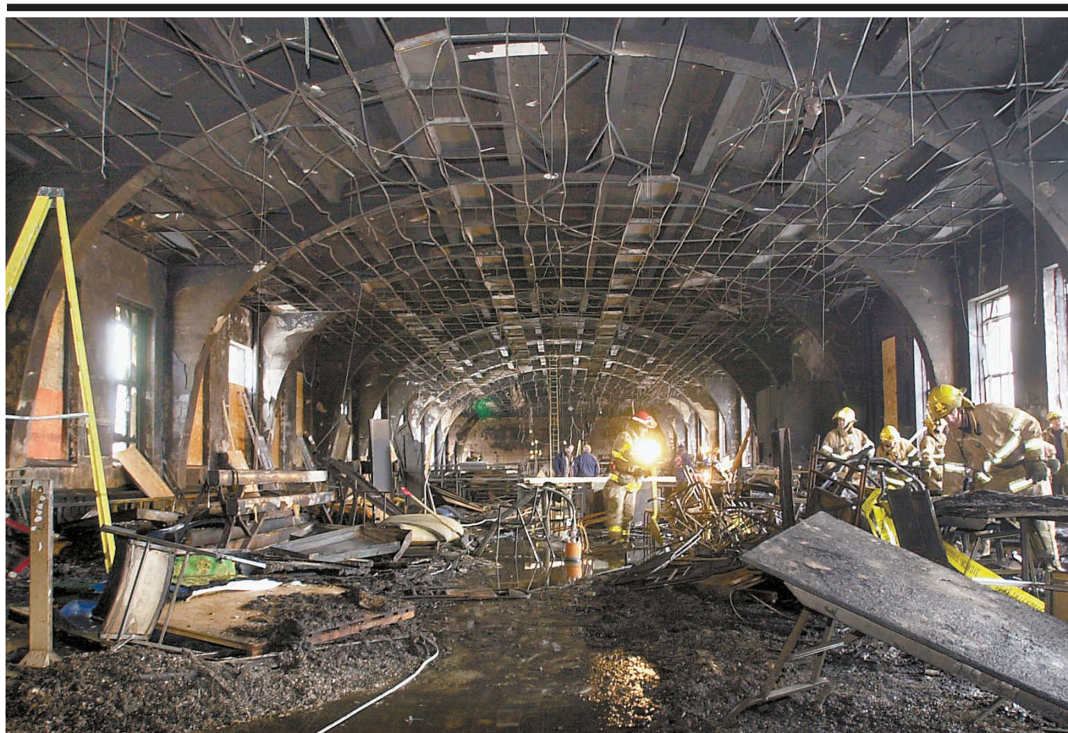
Des pompiers de Montréal, section recherche et cause des incendies, scrutent les ruines calcinées du gymnase où s'est déclaré l'incendie afin de déterminer la cause du sinistre.
