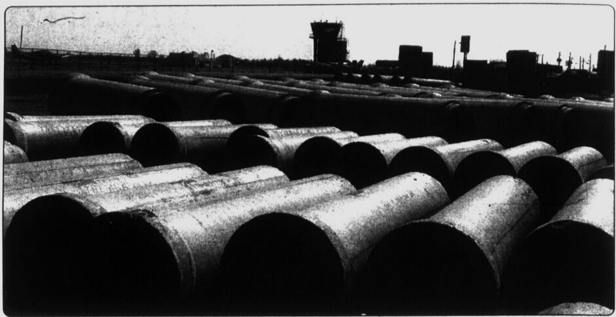
En raison des importants travaux de drainage à venir, l'entrée de l'aéroport ressemble à un lieu d'entreposage d'une compagnie de béton.
