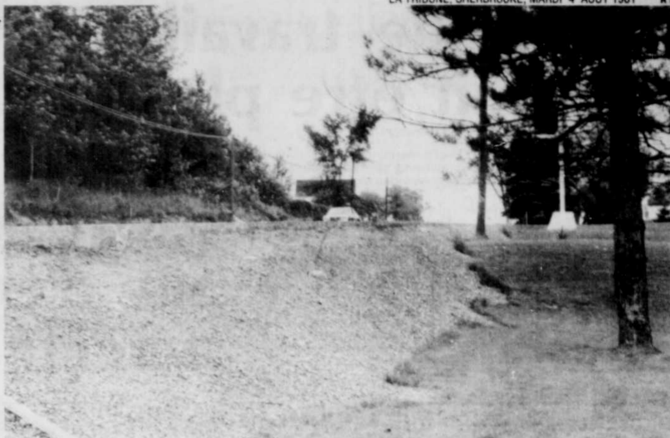
La disparition du fossé qui séparait la chaussée et les terrains inquiètent les riverains de la route 116 qui craignent des problèmes de drainage. La dévaluation de leur bien est aussi un des motifs qui a suscité cette contestation.
