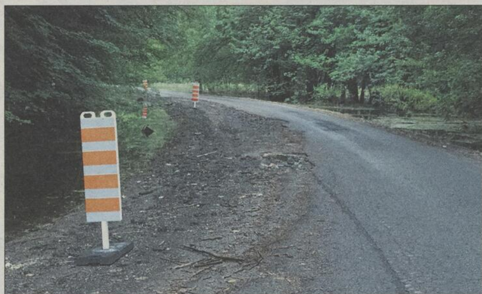
Des dommages ont été observés sur le rang de la Barbotte après le retrait des eaux.
