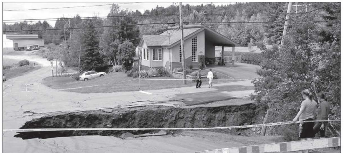
Les gros coups d'eau, comme les inondations des derniers jours à Beauceville, ne sont pas plus fréquents. C'est plutôt la valeur des biens que les gens entreposent dans leur sous-sol qui augmente. — PHOTO LE SOLEIL, YAN DOUBLET
