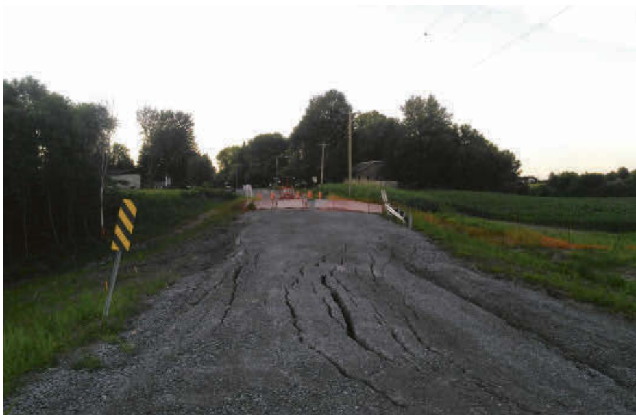
L'affaissement de la chaussée a été observé cet été sur le rang Bord-de-l'Eau à Saint-Aimé. (Photo : Gracieuseté)
