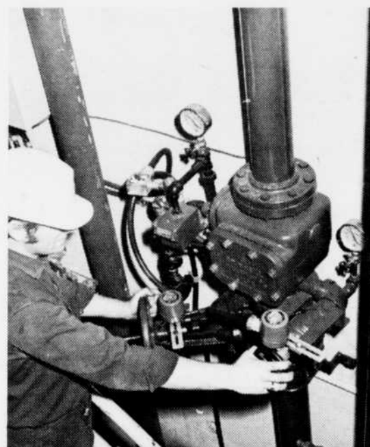
M. Benoît Harvey, de l'équipe de la mécanique de Chute-des-Passes s'assure du bon fonctionnement des conduites d'eau du système de protection contre le feu.
