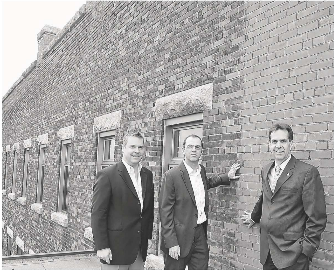
Les architectes Rémi L. Petit et Luc Roy expliquent à André Métras la façon pointue dont est menée la restauration des murs endommagés de brique et de maçonnerie au Séminaire de Sherbrooke.
