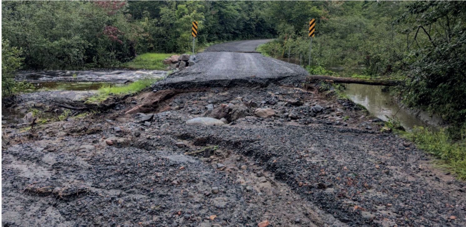
Plusieurs chemins de Saint-Alban ont été endommagés. Photo - Stéphane Pelletier
