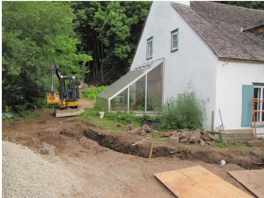
Figure 2. Vue des travaux d'excavation face au côté ouest de la maison. En direction nord, photo Serge Rouleau, A12-04-36.
