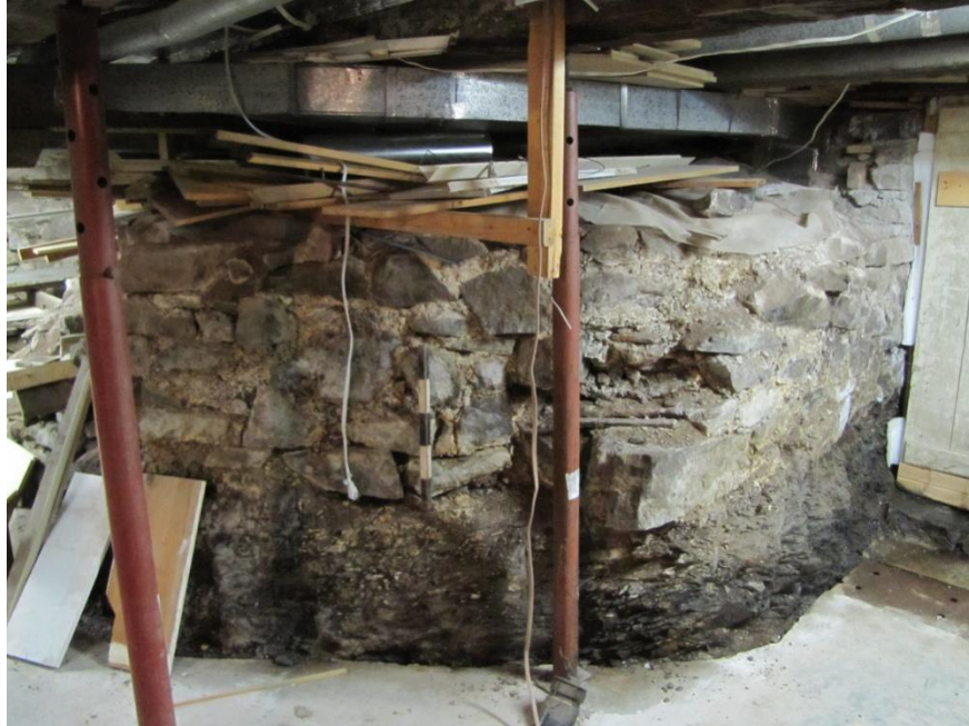
Figure 17. Vue des côtés nord et oriental de la structure 21Y4. Le prélèvement des sols au sous-sol a entraîné un déchaussement du roc supportant la structure. En direction ouest, photo Serge Rouleau, A12-05-06.
