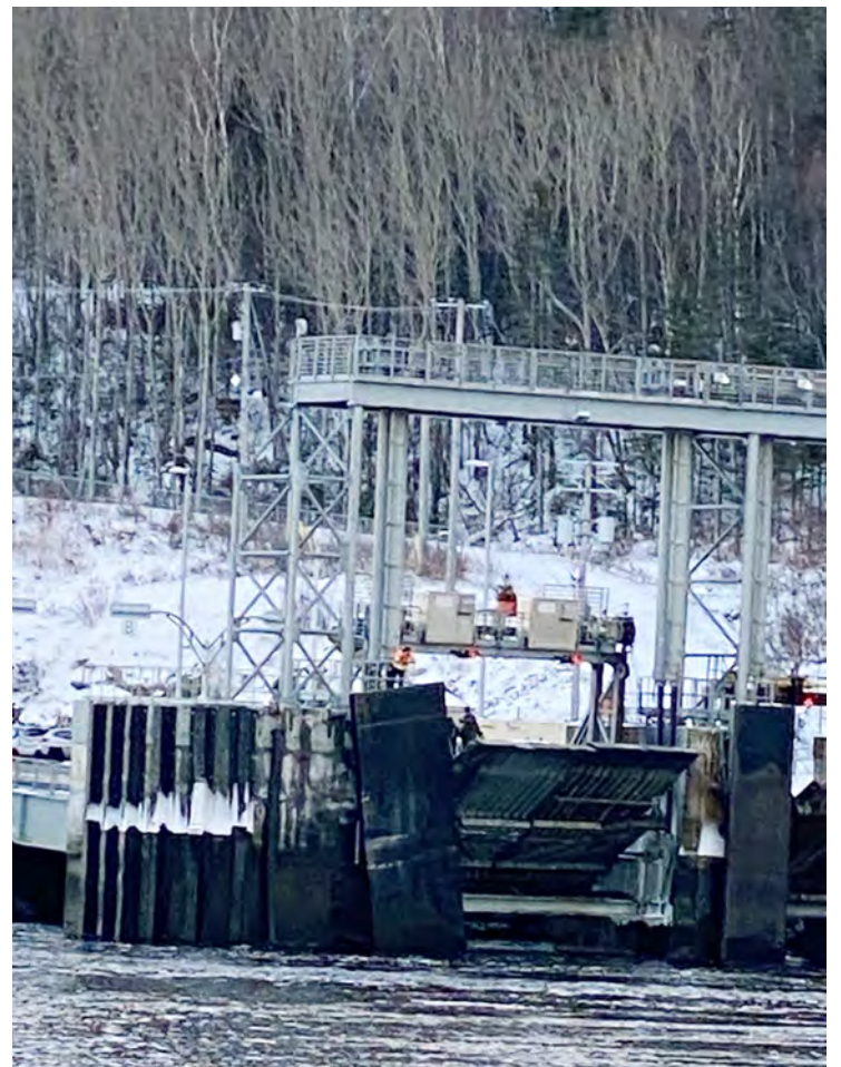
Sur cette photo fournie par un lecteur, on peut voir les dommages subis au quai de Baie-Sainte-Catherine, lesquels nécessiteront plusieurs semaines de réparation. Courtoisie
