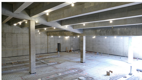
Géothermie Juillet à octobre 2017
