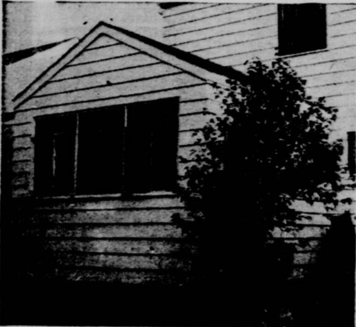
Que toutes les sections de votre toit subissent une inspection à cette époque de l'année. Faites les réparations nécessaires et appliquez une couche de peinture protectrice.
