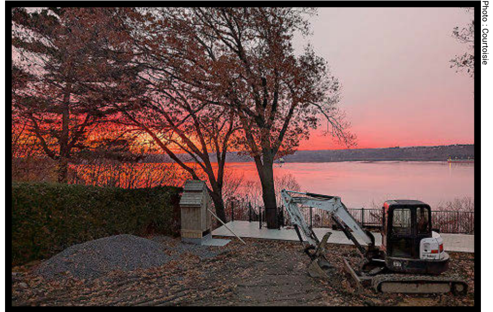
L'équipe de Fruga Construction travaille actuellement sur un projet de rénovation majeure à son quartier général de Saint-Augustin-de-Desmaures.
