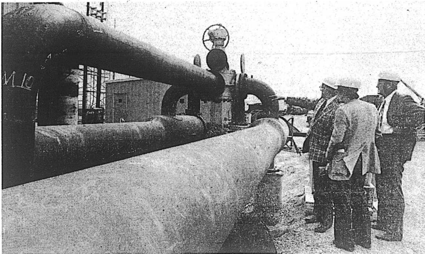
Un ouvrage pourtant gigantesque, le pipeline Sarnia-Montréal offre bien peu à la vue des curieux. De l'endroit où la canalisation sort de terre, près de la raffinerie d'Imperial Oil à Montréal-Est, tout ce qu'on peut voir est le modeste terminus montréalais du pipeline: deux bâtiments où sont installés les équipements de contrôle.
