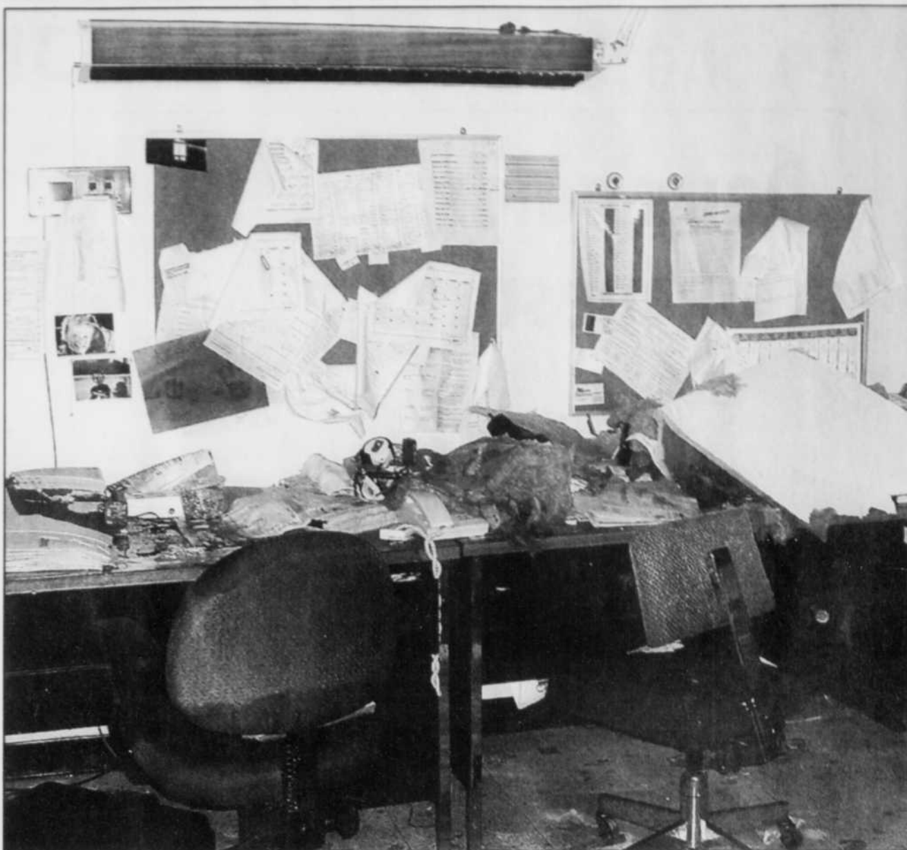
C'est dans ce local du sixième étage que la conduite d'eau a éclaté. Une fenêtre avait été laissée ouverte, ce qui a provoqué le gel de la conduite en question. Le local servait de bureau pour des membres du personnel de l'unité d'ergothérapie.
