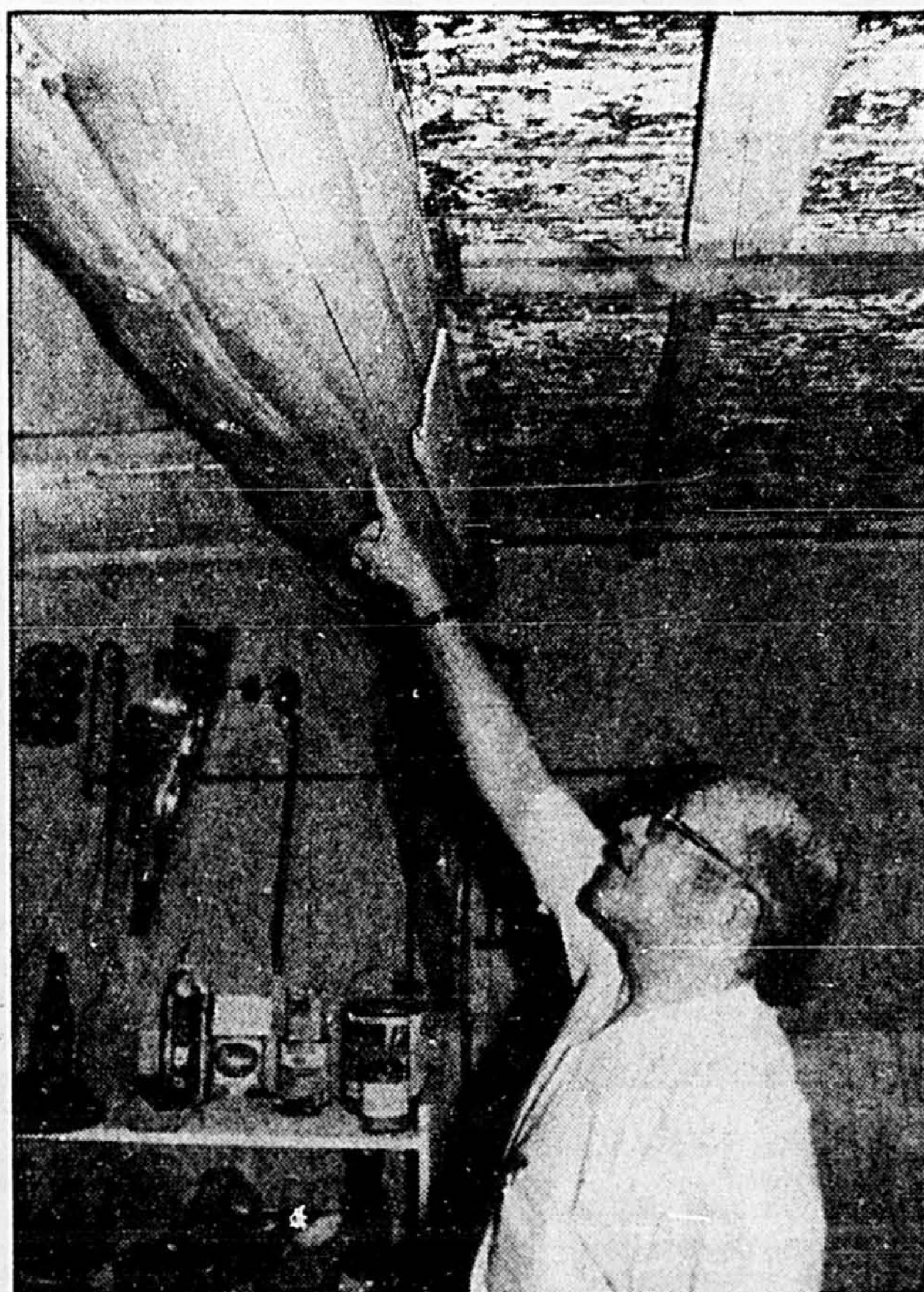
Jean-Paul Forest, le propriétaire de la maison, explique que pour soutenir celle-ci, les constructeurs placèrent des demi-cèdres à tous les cinq pieds.
