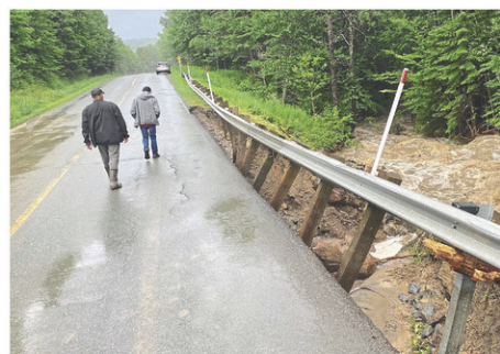
Des garde-fous ont été fragilisés, comme ici dans le secteur de Saint-Nazaire.
